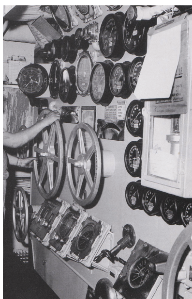
doc.2 Un tableau de manœuvre des turbines en septembre 1958.
